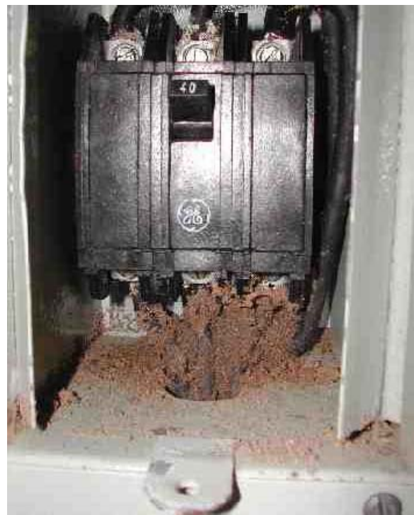
Figura 58 – Presença de cupins em quadros de disjuntores
