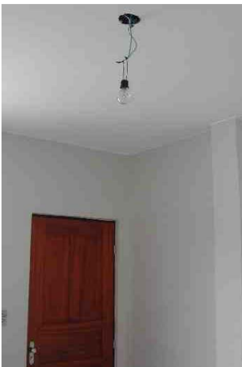
Figura 57 – Apartamento entregue sem luminária
