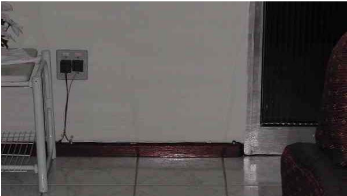
Figura 55 – Tomadas para telefone em quantidade e localização inadequadas
