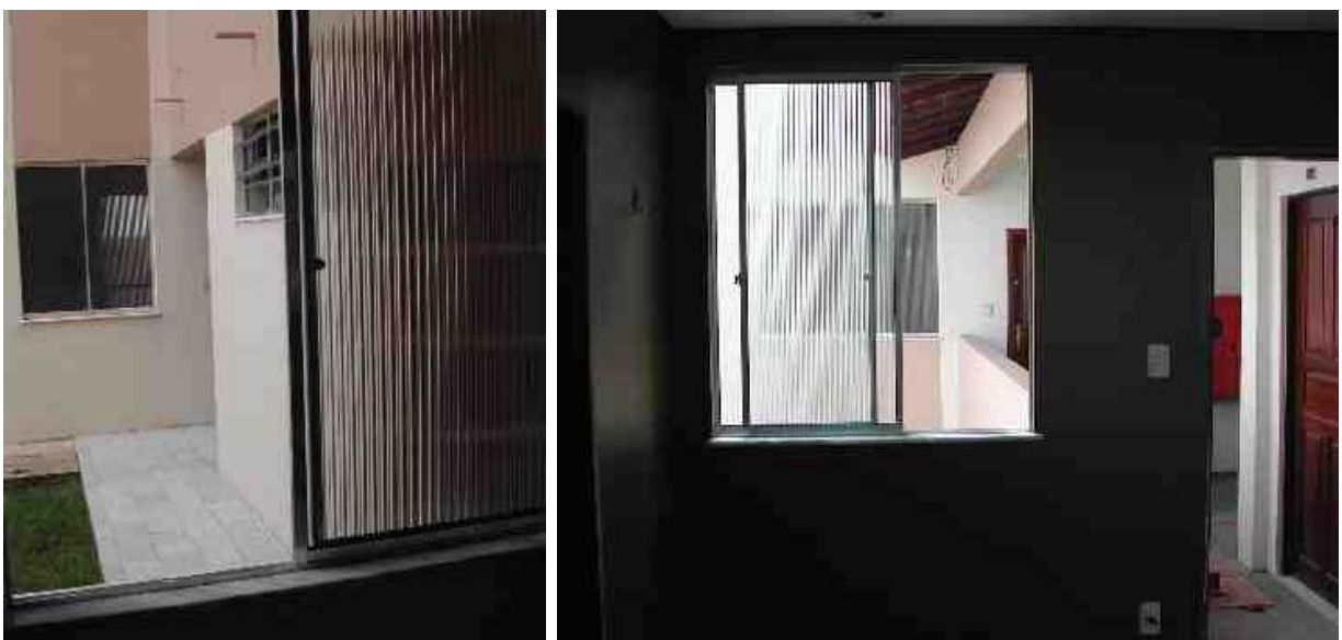
Figura 60 – Falta de privacidade entre unidades vizinhas
